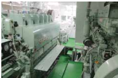
（左写真）デッキ上は通常のケミカル船よりもフラット （右写真）機関室内もメンテナンス性確保
